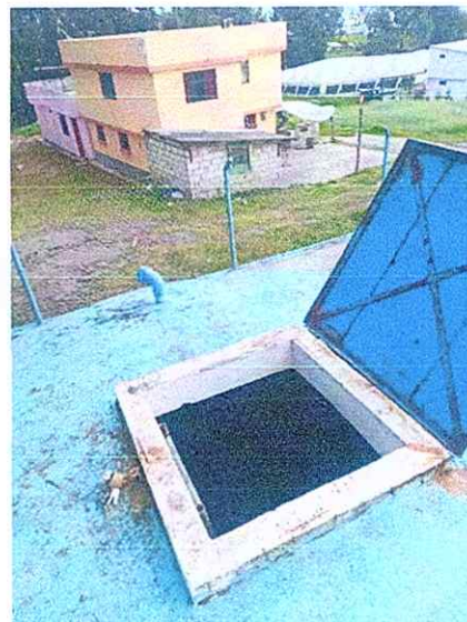
Monitoreo calidad de agua tanque de distribución de agua Cananvalle, EP EMASA PM 2025
