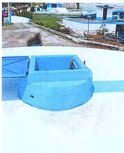
Monitoreo calidad de agua tanque de distribución de agua Planta Central, EP EMASA PM 2025
