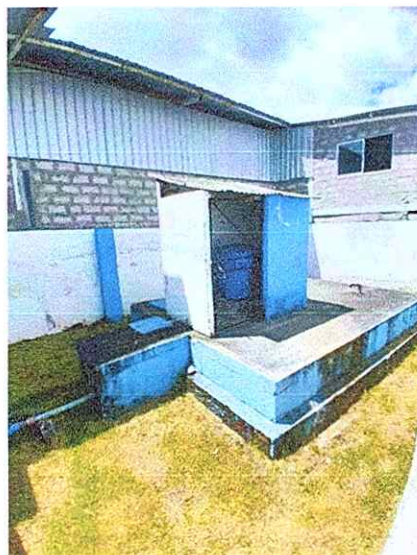
Monitoreo calidad de agua tanque de distribución de agua Simón Bolívar, EP EMASA PM 2025
